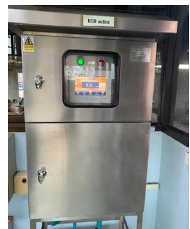
ระบบ BOD online ณ โรงงานน้ำยางชั้น สาขาตรัง
