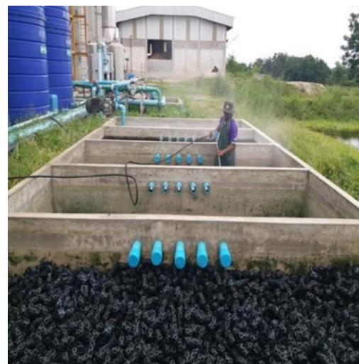
ระบบกรองน้ำรีไซเคิล เข้าระบบ wet scrubber
