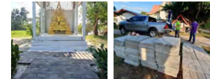
บริษัท ศรีตรังแอกโอรอินดัสทรี จำกัด (มหาชน) สาขาภาพสินธุ์ ดำเนินกิจกรรมปูพื้นทางเดิน ณ สำนักสงฆ์ธารน้ำใส บ้านคำเม็ก ตำบลไผ่ อำเภอเมืองกาฬสินธุ์ จังหวัดกาฬสินธุ์
