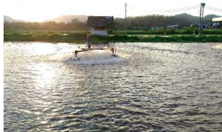
ระบบบำบัดน้ำเสียแบบเติมอากาศ
