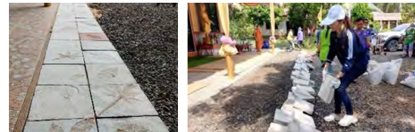
บริษัท ศรีตรังแอกโอรอินดัสทรี จำกัด (มหาชน) สาขาอุบลราชธานี ดำเนินกิจกรรมปูพื้นทางเดิน ณ วัดโนนใหญ่ อำเภวารินชำราบ จังหวัดอุบลราชธานี
