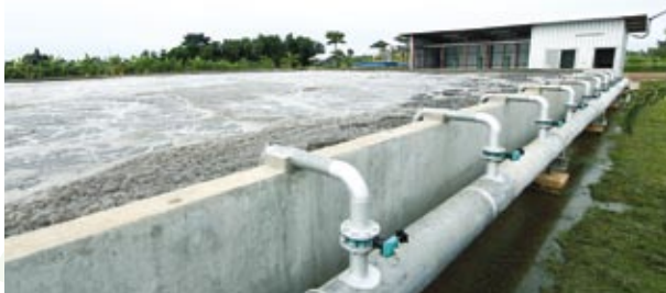
บ่อเติมอากาศของระบบบำบัดน้ำเสียแบบ Activated Sludge
