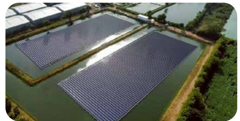
ระบบผลิตไฟฟ้าจากพลังงานแสงอาทิตย์แบบแผงบนทุ่นลอยน้ำบนผิวน้ำ สาขาสกลนคร และสาขาสระแก้ว
