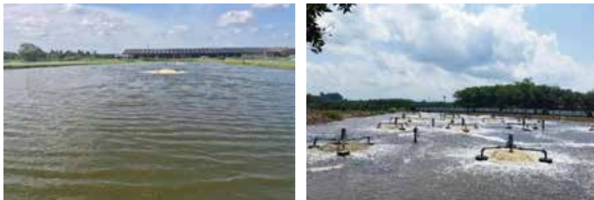
ระบบบำบัดน้ำเสียแบบเติมอากาศ (Aerated Lagoon)
